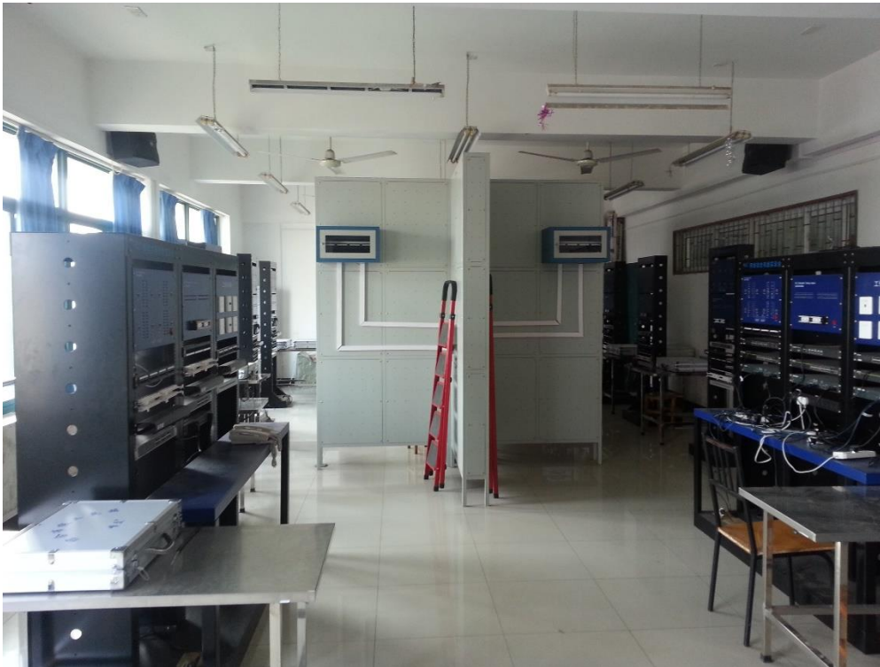
综合布线实训室全景
